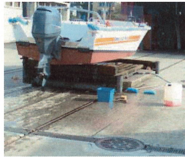
Waschplatz mit Anschluss an die Kläranlage
